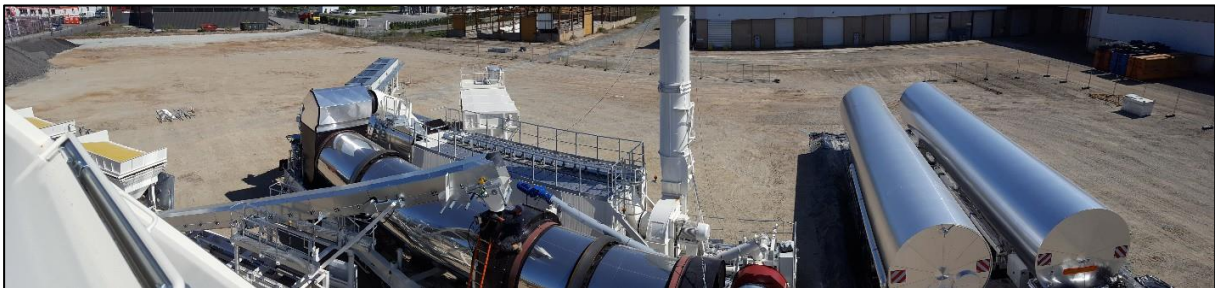
Figure 9 : Photographies illustratives de la centrale d'enrobage qu'il est prévu de mettre en place
